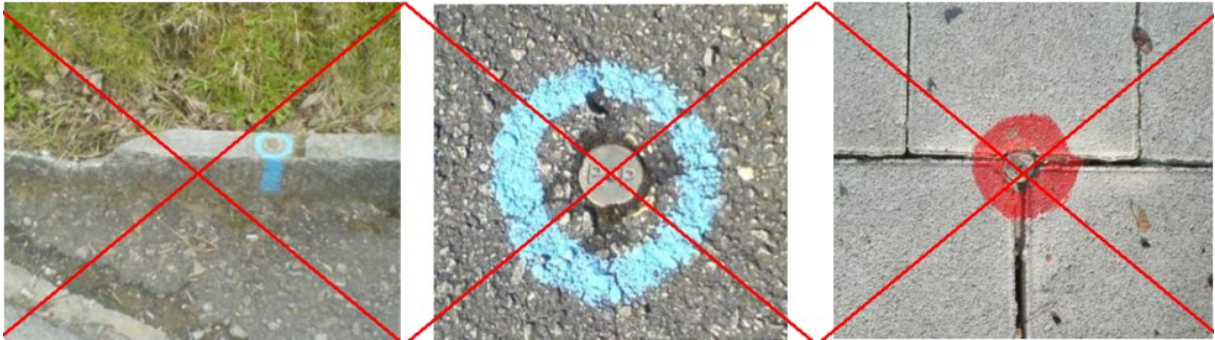
Abbildung 7: links: unzulässiger Bolzen in Randstein (Randsteinfuge zugelassen); mitte: unzulässiger Bolzen in Asphalt-Strassenbeleg; rechts: unzulässiger Bolzen in Verbundsteinen
