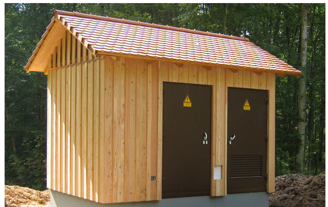
Trafostation mit Holzverkleidung
